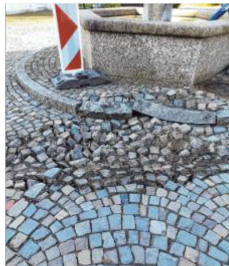
Die Beschädigungen rund um den Dorfbrunnen in Niederlaasphe werden immer deutlicher sichtbar.
